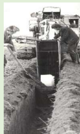
Идет укладка дренажа передо- вым экипажем многокошного экскаватора ПМК-2 возглавляемым В.Кановым, на 50 км. 1980 г.
